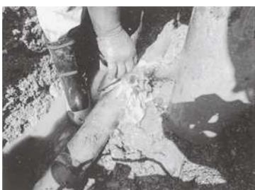
給水本管漏水
